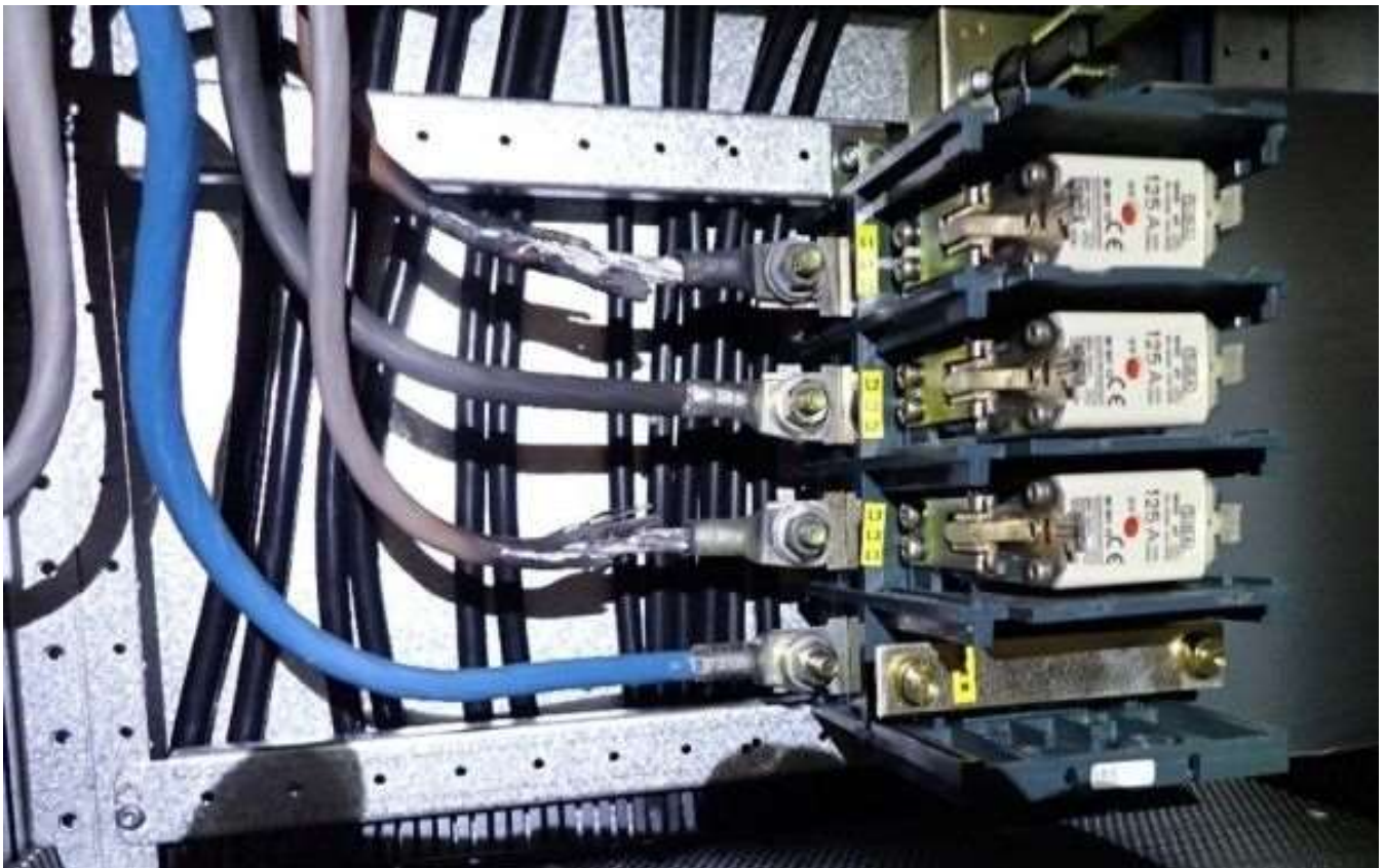
Kuva 2. Virheellisen mitoituksen ja huonon asennuksen aiheuttama palovaara
